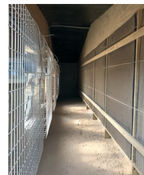
Светофильтры в фальш-стене перед вентиляторами
