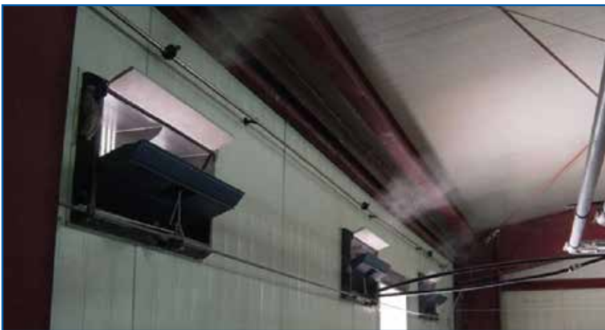
Рис. 118: Пример системы спрей-охлаждения в птичнике с перекрестной вентиляцией.
