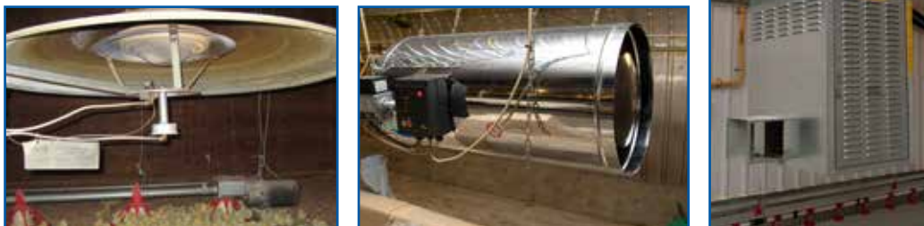
Рис. 98: Примеры различного оборудования отопления (слева направо: подвесной брудер, отопление всего птичника, воздушный нагреватель).
